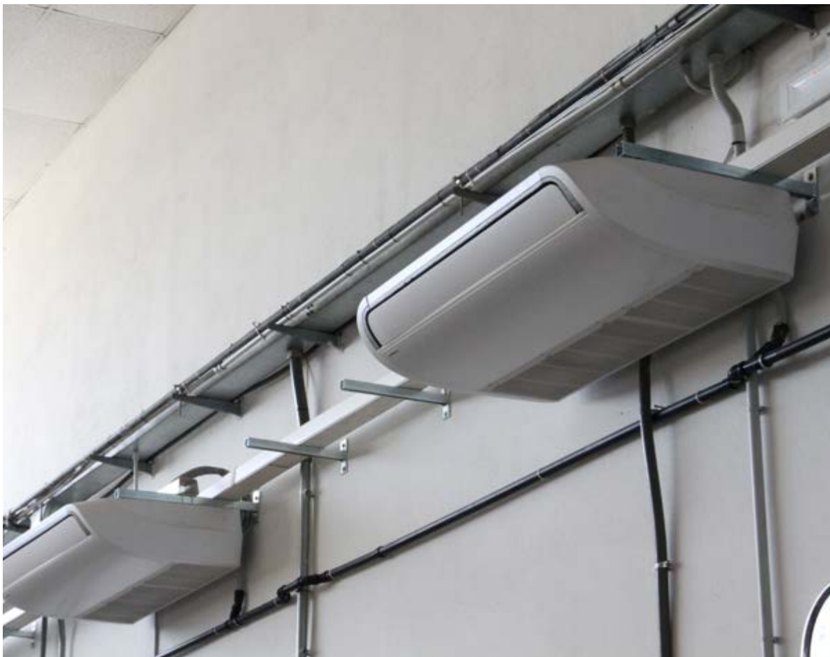
Impianto di condizionamento nel settore produttivo
